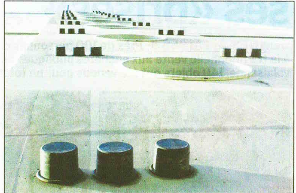
Insolite! Ces boulons géants renforcent le bâtiment de la police cantonale à Sion, modèle valaisan en terme de mesures parasismiques.
